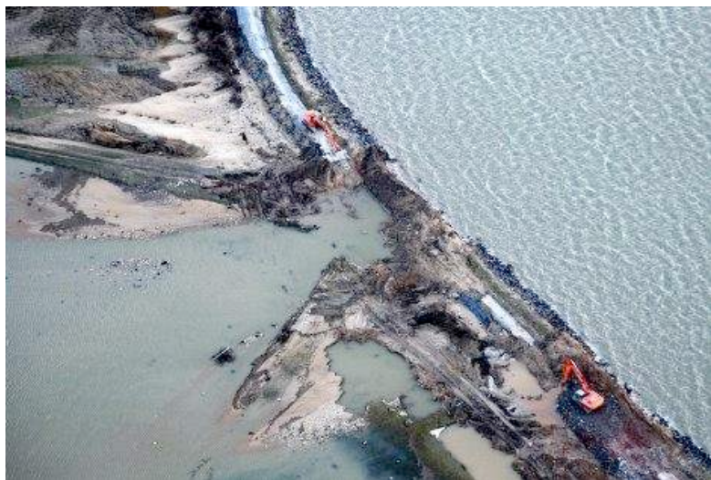
2 - La digue détruite sur la commune de la Faute-sur-mer, après le passage de la tempête Xynthia Photo : Philippe Chereh URL : http://www.ouest-france.fr/
